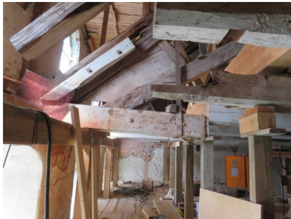
Bild 5 Mehrfach in der Vergangenheit saniertes Auflager
