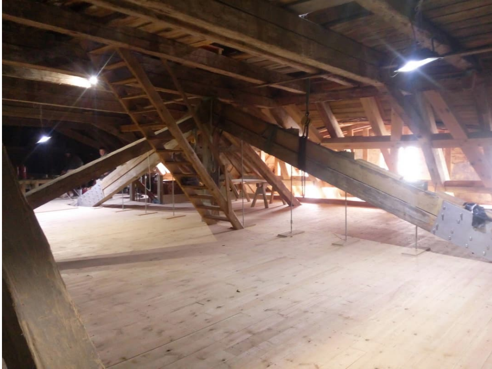
Bild 1 Blick auf das Hängewerk über dem Treppenhaus im Kernbau nach Abschluss der Maßnahmen zur Notsicherung in diesem Bereich
